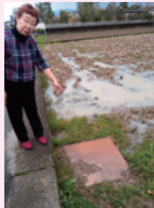
図書館西、佐味田川ぞいの用水路の蓋がなくなっており、危険と要望し実現しました
